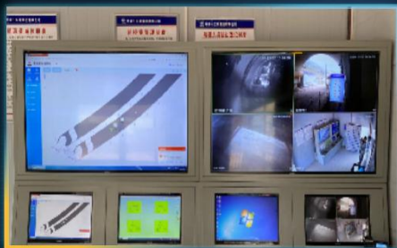
大伍龙萸隧道值班室操作台
