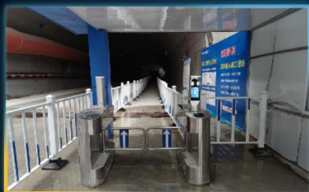
芒市隧道人员门禁
