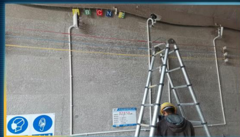
小燕塘隧道监控点位安装
