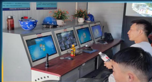
新村隧道操作台
